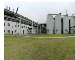
广西皖维乙醇制乙烯装置一角
